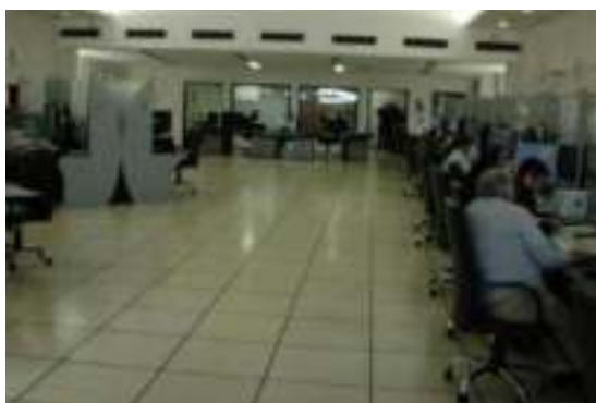
FIGURA X – 29 – Distintas vistas del equipamiento de INDRA instalado en la sala del ACC/TMA/APP EZEIZA
