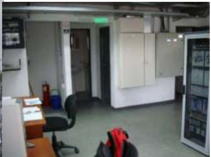
Sala radar estandarizada
