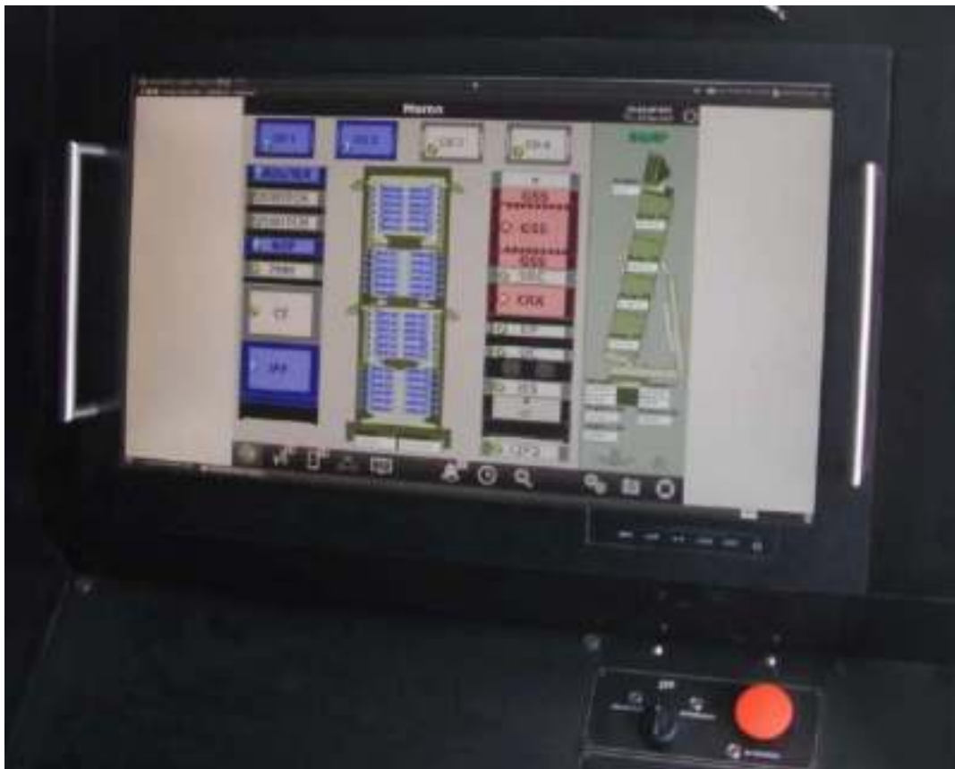
FIGURA IX – 25 – Vista completa del “Mímico” del Sistema de Radar
